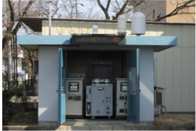
モニタリングポスト内部(大熊町 大野局)
